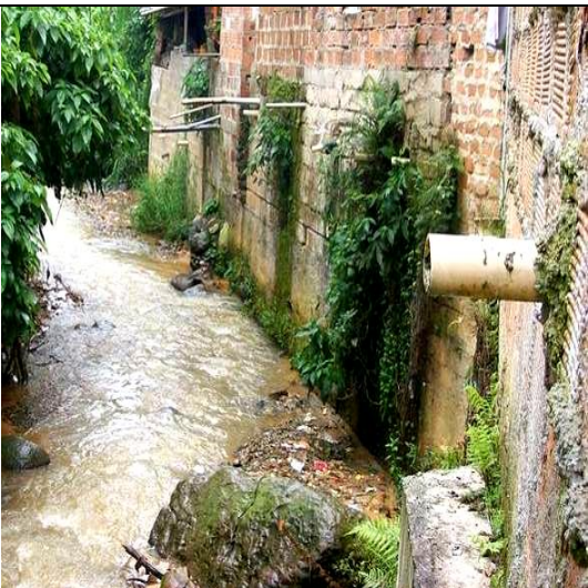
Invasión de cauce y vertimientos de aguas residuales domésticas sobre la quebrada La García
